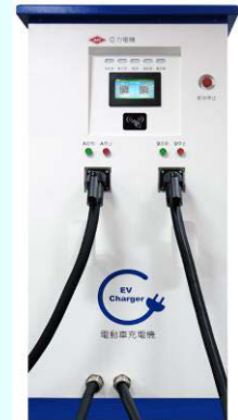
電動車直流充電樁
